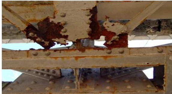
Φωτ. 1. Θέσεις καταστροφικής διάβρωσης σε φορέα σιδηροδρομικής γέφυρας.
