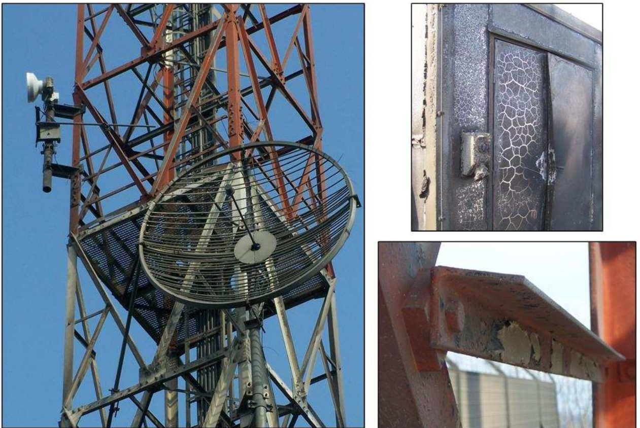
Σχήμα 1 Φωτογραφίες ιστών μετά την πυρκαγιά
