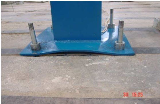
Εικ. 3 Ανατροπή της πλάκας βάσης του υποστυλώματος
