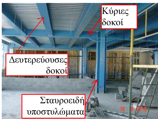
Φωτ. 5 Σύνδεση δοκών-στύλων πλαισίων
