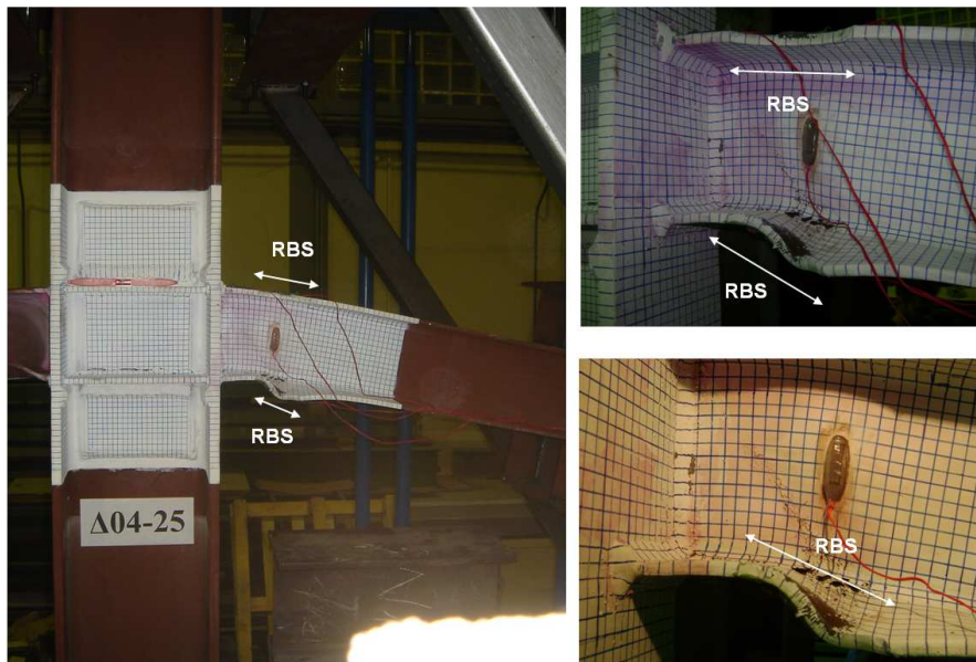
Φωτ. 3: Η παραμόρφωση του κάτω πέλματος της δοκού για 0.12 rad στροφής (RBS4)
