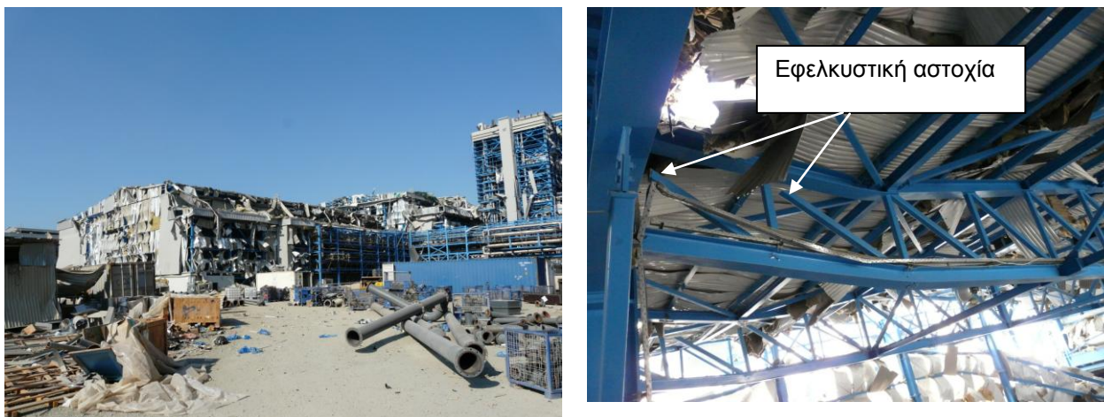
Εικ. 6 Παρατηρηθείσα αστοχία - Αριστερά: Γενική άποψη - Δεξιά: Αστοχία ζευκτού.
