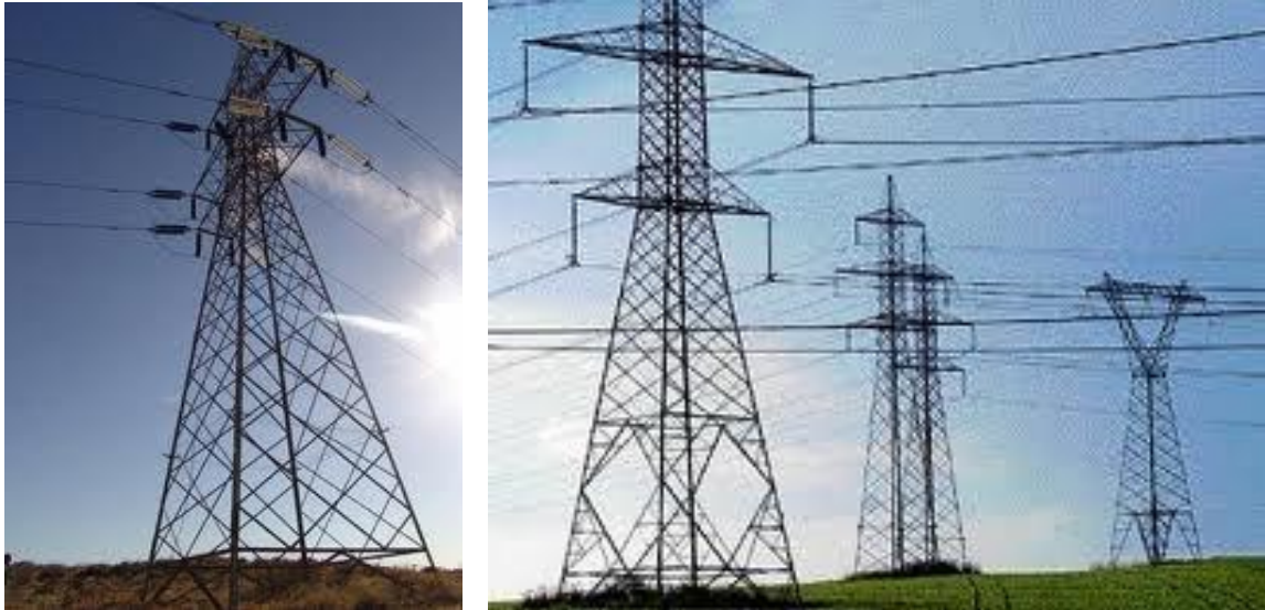
Σχήμα 1. Δικτυωτοί πυλώνες μεταφοράς ηλεκτρικής ενέργειας.
