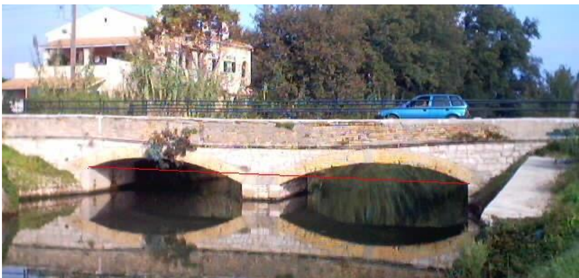
Φωτ 4: Η τοξωτή γέφυρα. Είναι προφανής η υποχώρηση του μεσοβάθρου.
