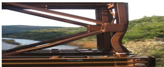
Φωτ. 3 Οξειδωση μελών του φορέα
