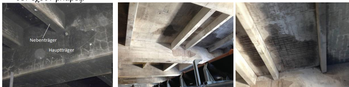
Σχ. 14. Βλάβες στο φέροντα οργανισμό κτίριο Bunker
