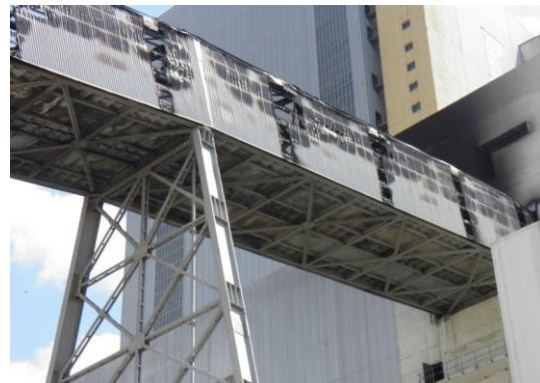
Σχ. 6 Εικόνα από το έδαφος της γέφυρας ταινιόδρομου μετά το πέρας της πυρκαγιάς
