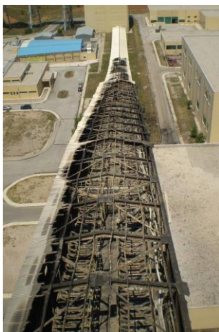
Σχ. 3. Εικόνα άνωθεν της γέφυρας ταινιοδρόμου μετά το πέρασ της πυρκαγιάς.
