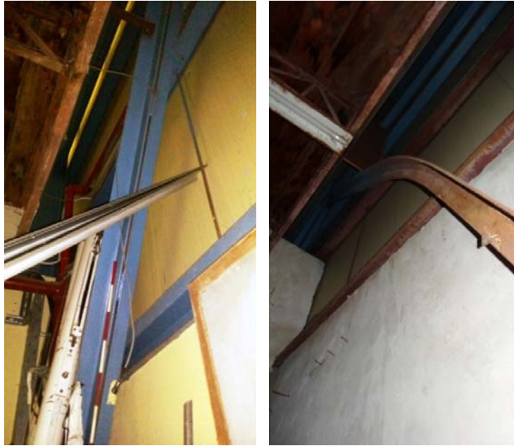
Εικ. 6: Μεταλλικός σύνδεσμος με οξείδωση και πολύ σημαντικές παραμορφώσεις 2ας τάξεως. Αριστερά ο έτερος σύνδεσμος του ίδιου συστήματος τύπου Λ (νότια όψη).
