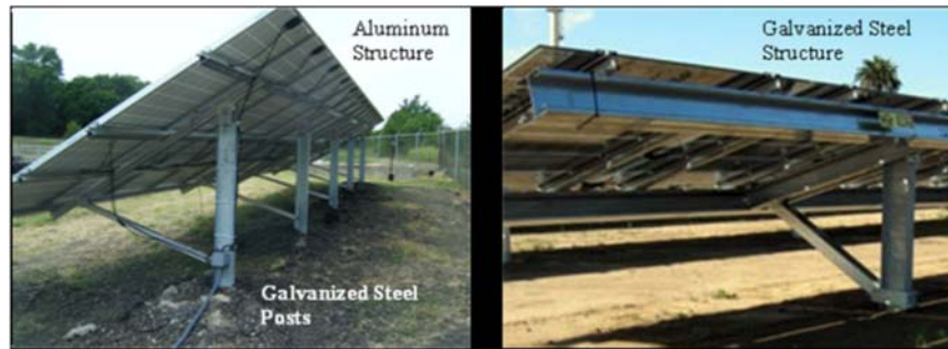
Φωτ. 1. Τυπική συστοιχία φωτοβολταϊκών πάνελ
