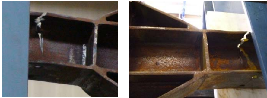
Φωτ. 4 Επέκταση ρωγμών στα πλαίσια Π1 και Π2
